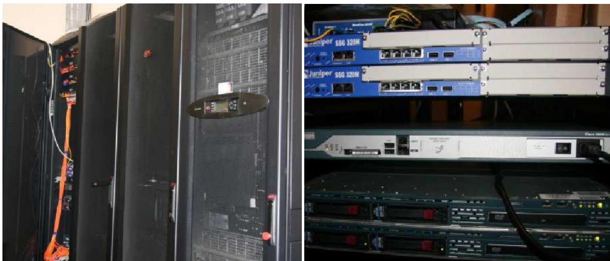
Рис. 4.2.2 - Серверное и коммутационное оборудование головного центра
